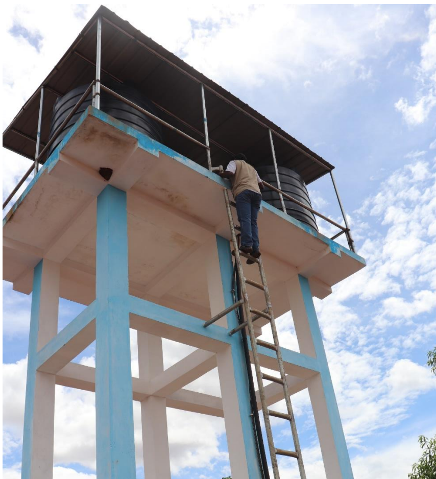
Verificação de um sistema de abastecimento de água
